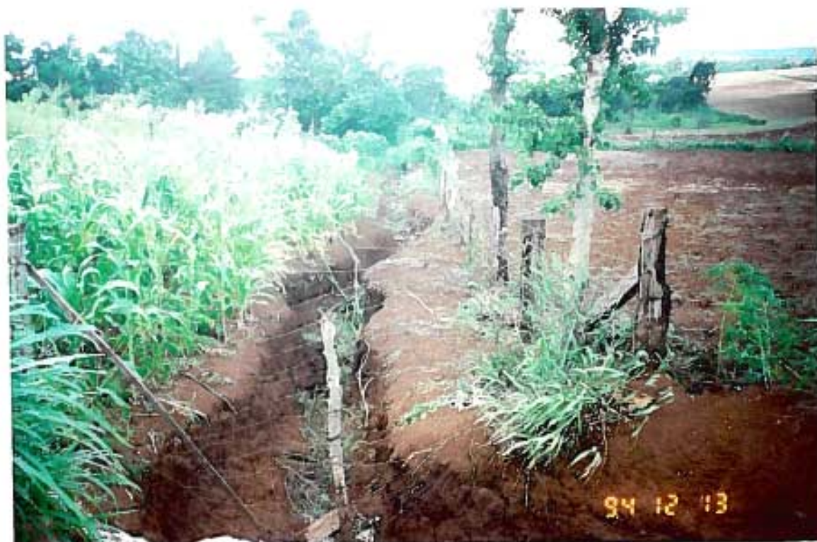
Foto 06 - Escoamento superficial de modo mais desenvolvido, formando processos erosivos com escavações de sulcos e ravinamentos.
