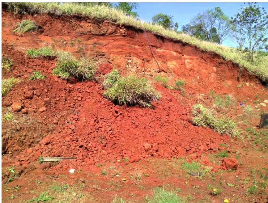
Foto 4 - Vista de corte em terreno na Rua dos Palmitos, ponto 05 (Mapa Setor 3). Afloramento de rocha, solo raso e material deslizado.
