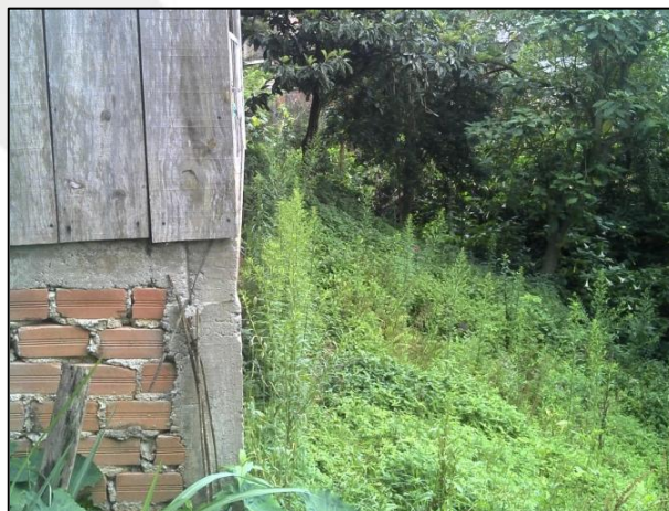
Fotografia 8. Habitações localizadas em áreas de alta vulnerabilidade a movimentos de massa (DSC00253).
