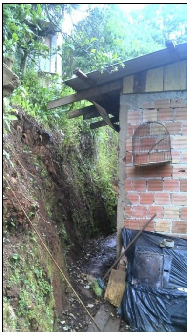
Fotografia 5: Corte de terreno para conter MGM (DSC00252).
