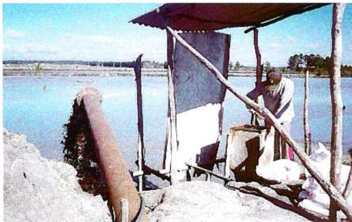
Detalhe do dosador de sal para tratamento da água
