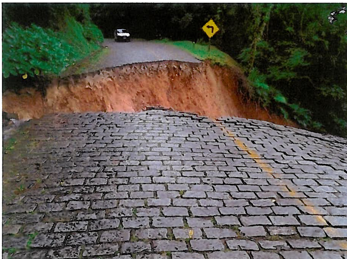
Figura 1. Local de origem do deslizamento de solo no leito da estrada da Graciosa, sem vestígios de muro de arrimo.
