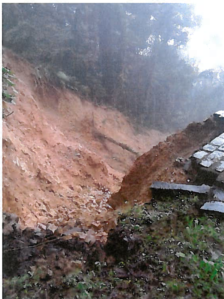
Figura 2. Vista da feição erosiva formada pelo movimento gravitacional de massa no leito da estrada da Graciosa. Foto: DER.
