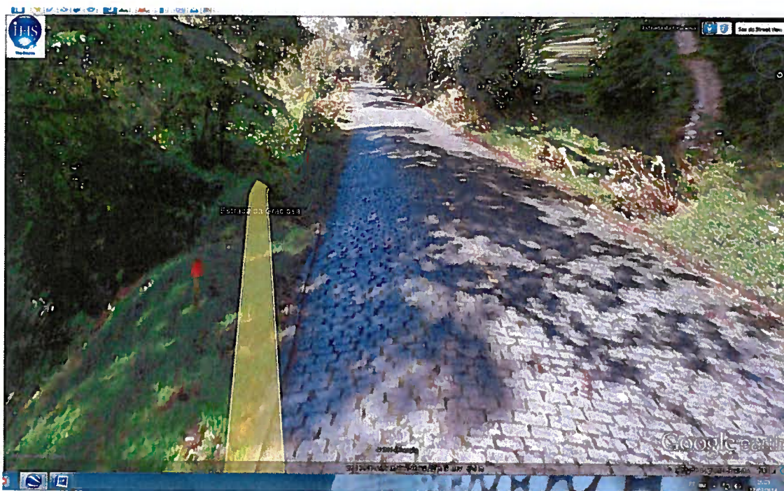
Figura 7. Vista oposta à Figura 6, onde se confirma a ausência de muro de arrimo e a deformação do leito da estrada em imagem do Google Street View de 2014.
