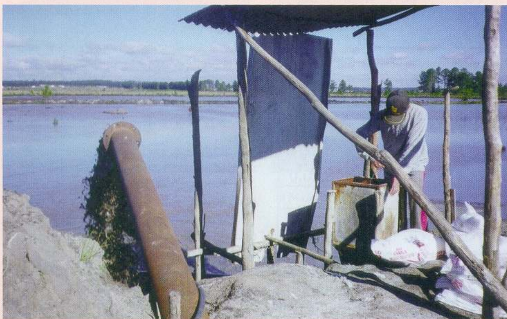
Detalhe do dosador de sol no processo de tratamento
