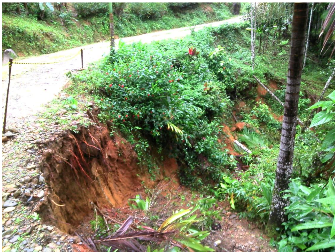
Outra vista da escarpa mostrando a manilha quebrada e o risco de desmoronamento de parte da estrada com o avanço do processo. A palmeira à direita, em primeiro plano, estava ao nível da estrada.
