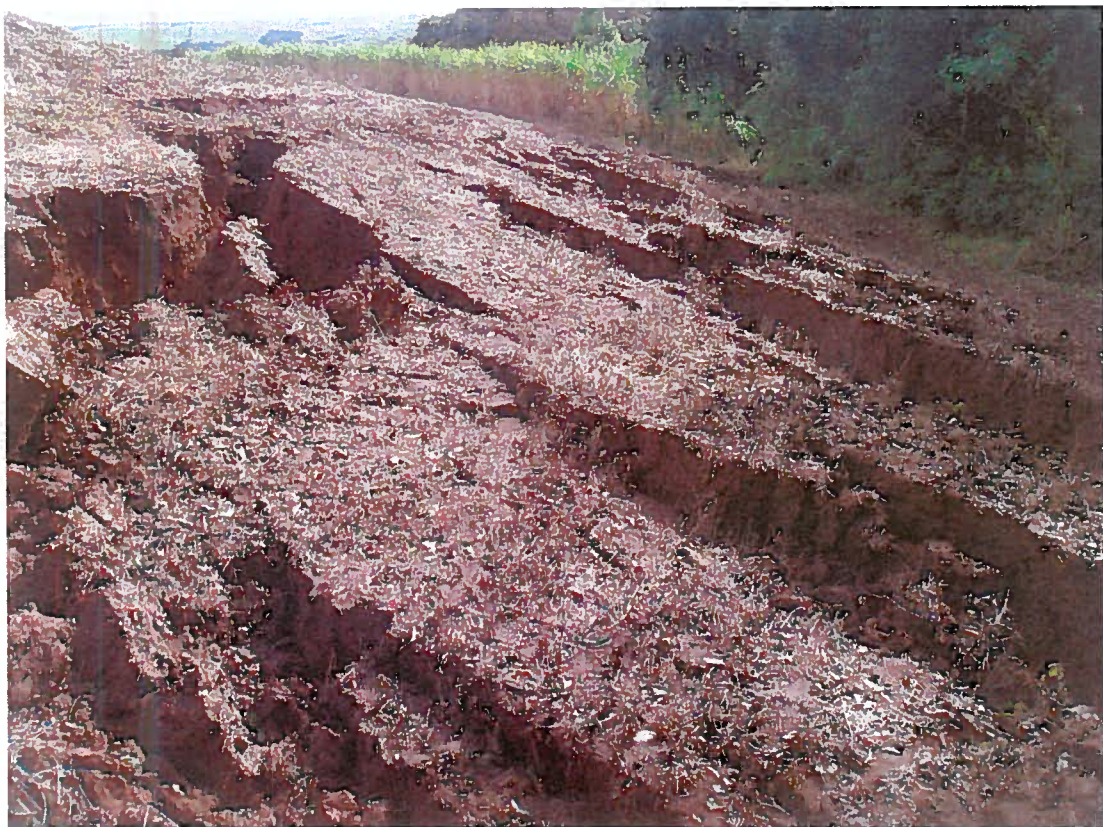
Foto 3 - Neste local, em declividade mais acentuada uma concentração de fissuras com abatimento de até 0,5m.
