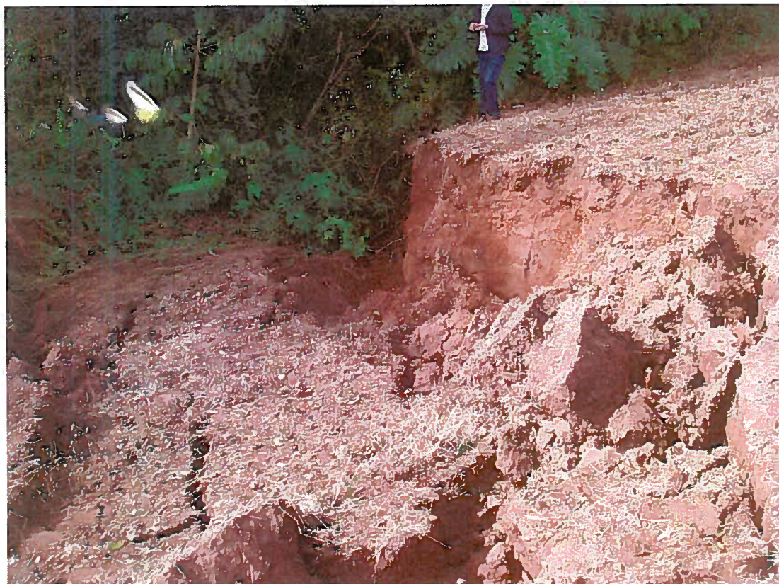
Foto 4 - Local onde ocorrem os maiores abatimentos, com até 3,0m, mais próximo à drenagem.
