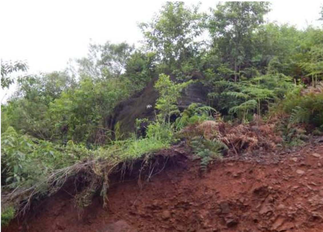
Foto 4: bloco localizado na parte superior do deslizamento e encontra-se instável podendo rolar caso haja nova desestabilização no talude.
