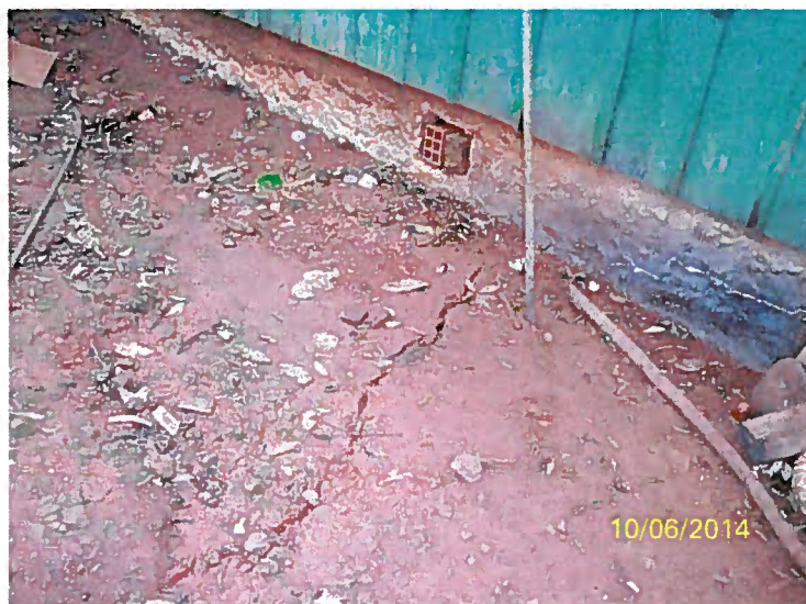
Foto 2. Rachadura nas fundações da moradia, sobre a trinca principal.
