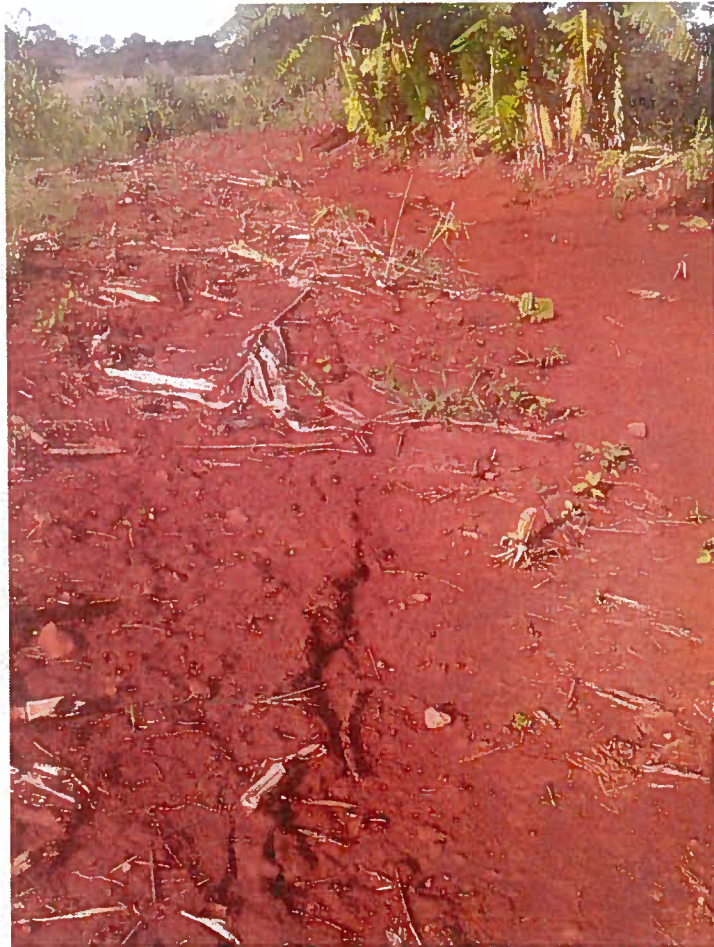
Foto 3. Trinca com abatimento, cerca de 50 m a E da casa.
